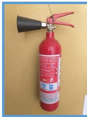
EXTINTOR DE CO2
