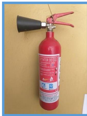
EXTINTOR DE CO2
