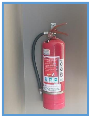
EXTINTOR DE PQS
